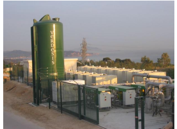
Aperçu de l'installation biogaz à la Ciotat
